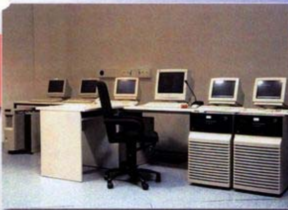
Сервера и рабочие станции тренажера
